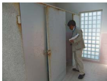
■施設老朽状況調査
